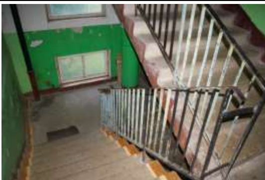
Būve ar kadastra apzīmējumu 1700 002 0062 008, koplietošanas telpa
